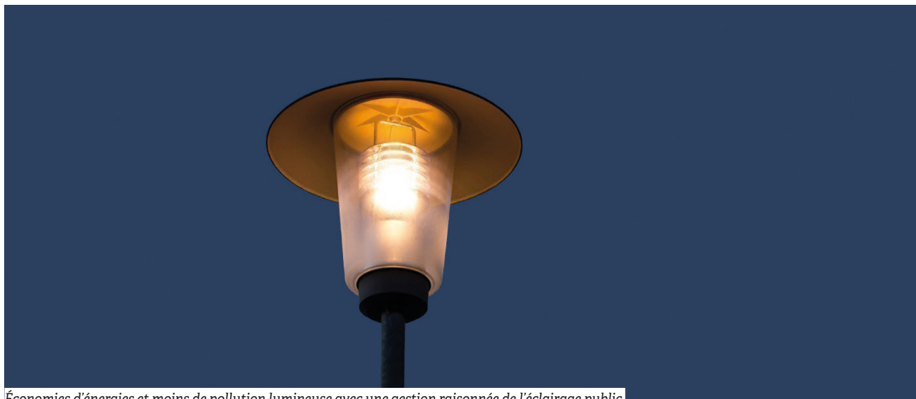
Économies d'énergies et moins de pollution lumineuse avec une gestion raisonnée de l'éclairage public.
